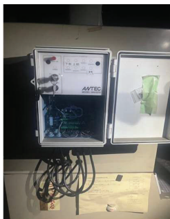
火炎センサーのモニター アラーム検知されると検知箇所が点灯する。 ※下の張り紙は火災検知器発報時の対応手順
