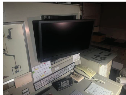
監視用モニター
